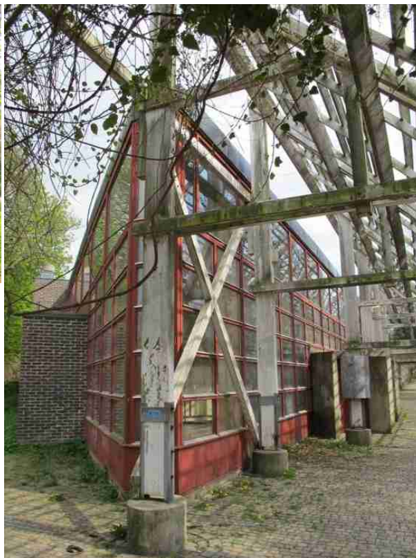
Rödmålad plyfva i underdelen av fönsterpartier där norra och sydvästra fasaden möts.
