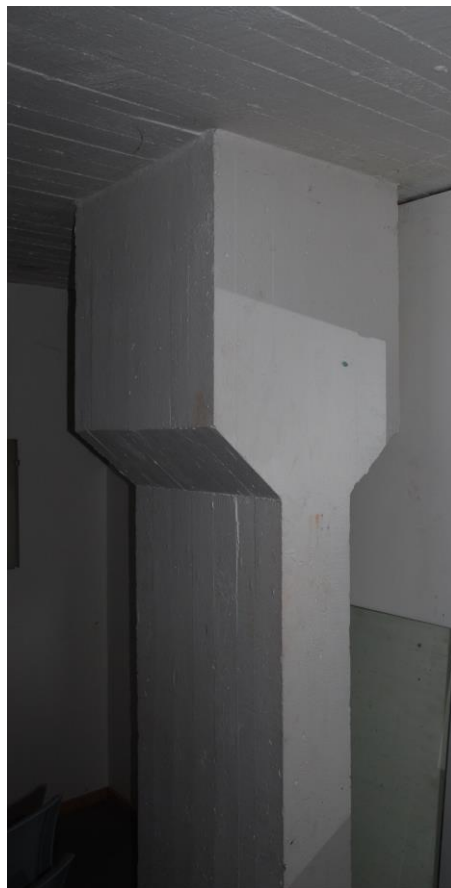
Bild 1. Källaren, inspänningskraft från limträpelare i bottenplan har tagits upp i förstyvning i betongpelare. Betongbjälklaget har gjutits på brädform, varför betongytan uppvisar ett mönster av träets fibrer. Bild: Malena Larsvall
